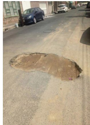
(d) Sinkhole, Coyoacán
